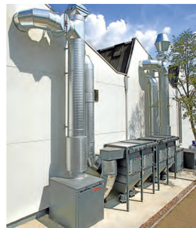
Zentrale Absauganlage mit je zwei DUSTMAC S Filtermodulen
