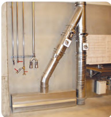
Staubfassung durch spezielles Rohrleitungssystem
