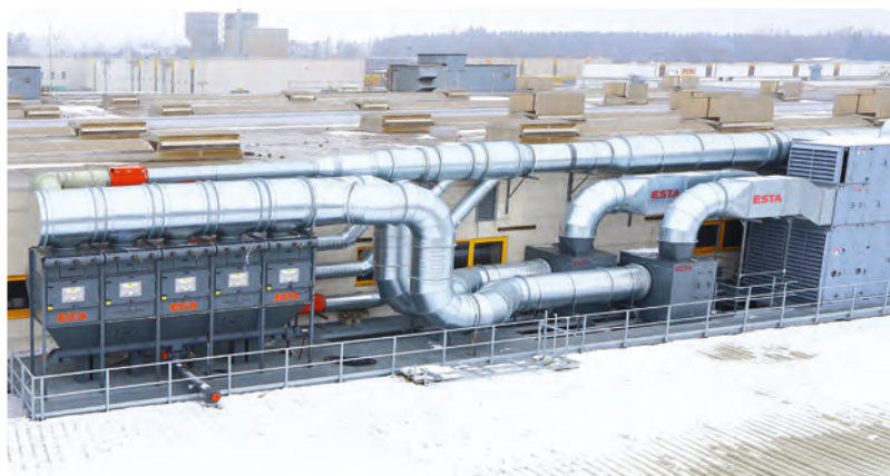
Absaugsystem ist auf dem Dach der Produktionshalle installiert
