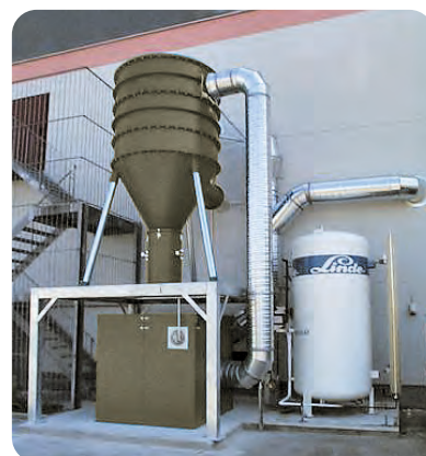
Filterzyklon auf einer Stahlkonstruktion
