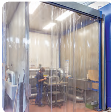
An den vier Schleifkabinen sind Nassab- scheider installiert, um die teilweise explosi- onsfähigen Stäube sicher abzuscheiden
