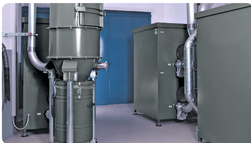
Zentrale Staubsaugereinheit mit zwei Seitenkanalverdichtern ausgestattet
