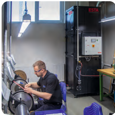
Nassabscheider DUSTOMAT HYDRO in der Schleiferei
