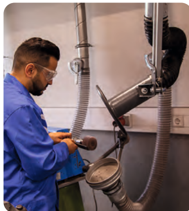
Absaugarm an Schleifarbeitsplatz
