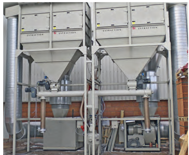
Zentrale Absauganlage mit zwei Zellenradschleusen zum kontinuierlichen Austrag von Ziegelstaub
