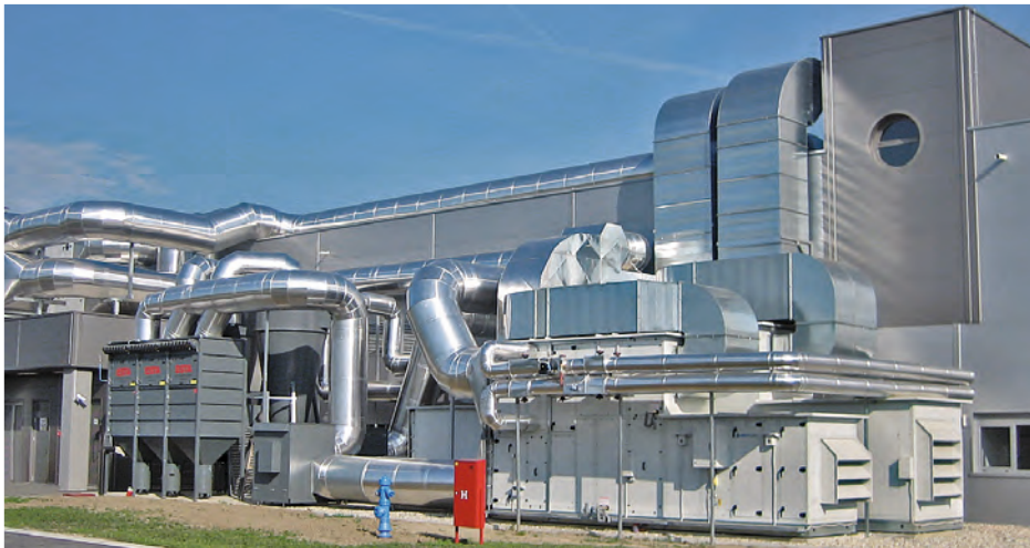
Zentrale Absauganlage mit Wickelfalzrohrsystem in der Schuhindustrie
