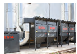
Rohrsystem als Zuleitung für zentrale Absauganlage
