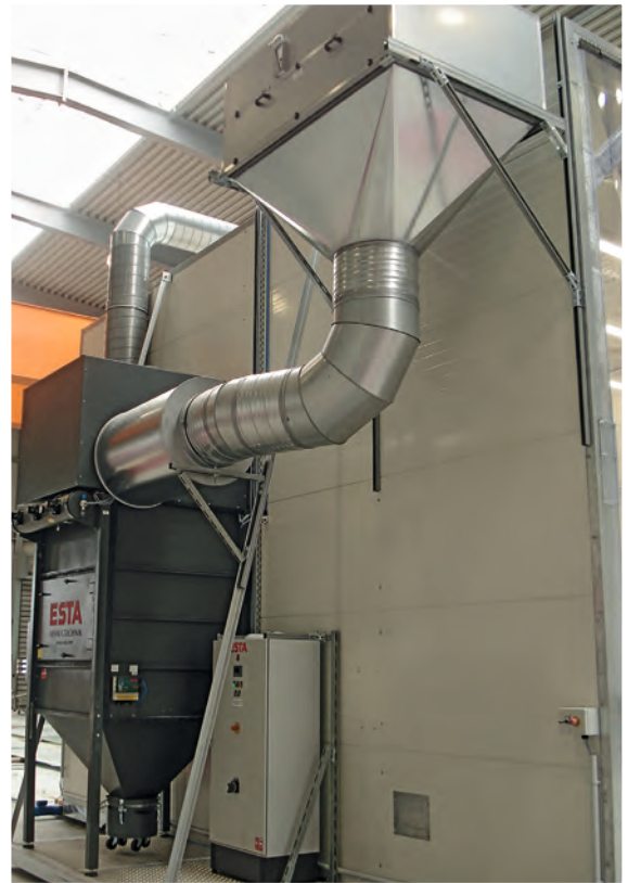
Modulare ESTA Absauganlage DUSTMAC F-144 mit Nachfilter zur Absaugung von GFK-Schleifstaub
