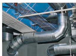
Verbindungsrohr zwischen Ventilator und Filteranlage
