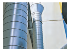
Abluftr Rohrleitung mit Deflektorhaube
