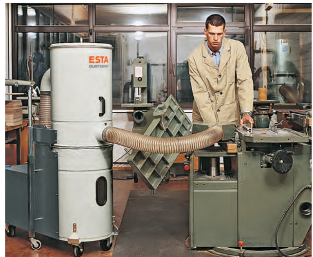
ESTA DUSTOMAT-10 mit PU-Schlauch an einer Kreissäge installiert zur Absaugung von Holzstäuben
