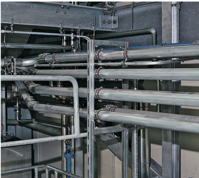
Stahlrohrsystem einer zentralen Absauganlage in der Tabakindustrie
