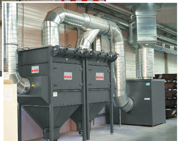
Nachfilter an der zentralen Absauganlage DUSTMAC F-288 installiert
